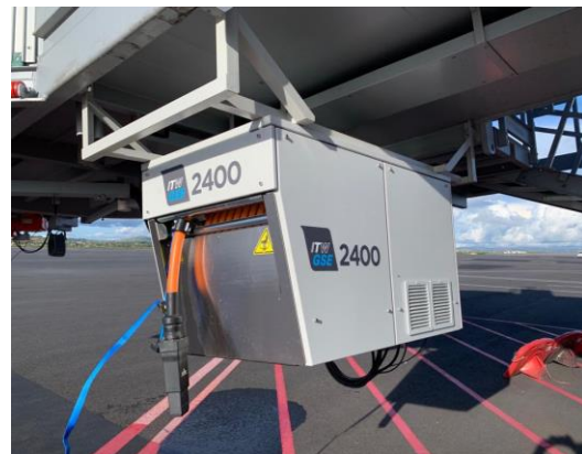
Abbildung 2: Beispiel einer brückenmontierter Bodenstromanlage (90 kVA Statischer Umformer und Kabelrolle in einem gemeinsamen Gehäuse), ITW GSE - 2400 Power Coil (Bildquelle: ITW GSE, 2024)
