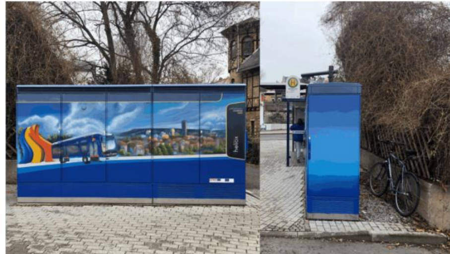
Kompletter Aufbau einer Ladestation mit Anschluss an das Niederspannungsnetz – Endhaltestelle Jena Westbahnhof (Quelle: Fraunhofer IVI)
