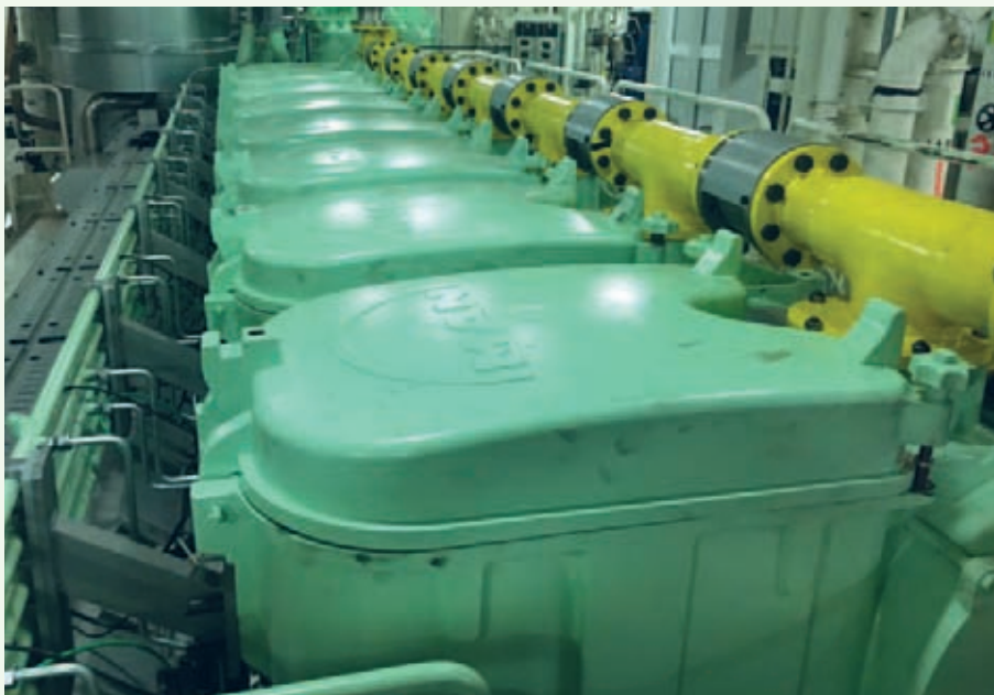
Blick in den Maschinenraum auf die umgerüstete 9-MW-Hauptmaschine-MAN 51/60DF
