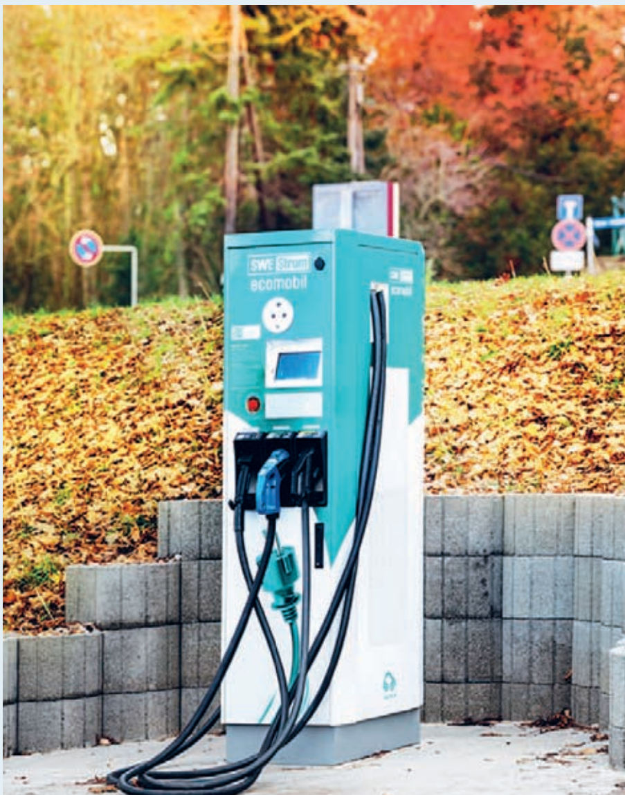
Ladestation an der Thüringen Halle
