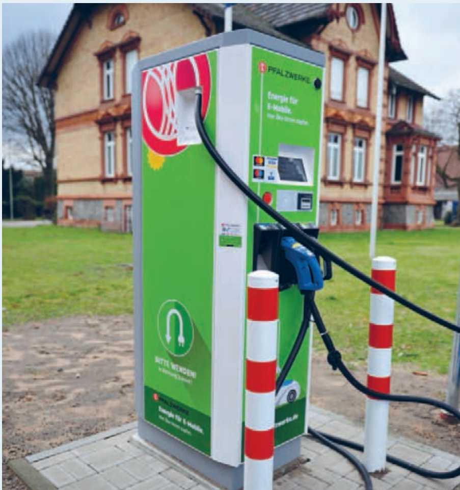
Geförderte Ladesäule mit Anfahrtsschutz
