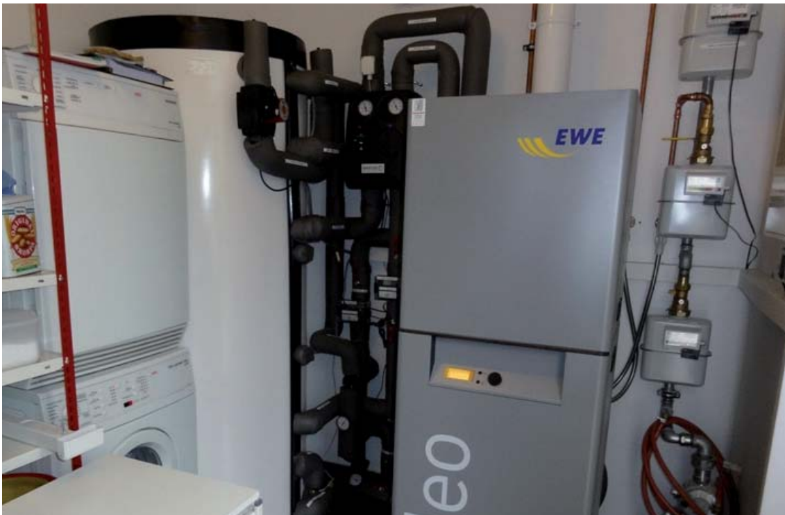
Abbildung 20: Brennstoffzellen-Heiz- gerät nach Abschluss aller Arbeiten (da es sich hier um ein Gerät im Feldtest handelt, sind drei Gaszähler installiert).
