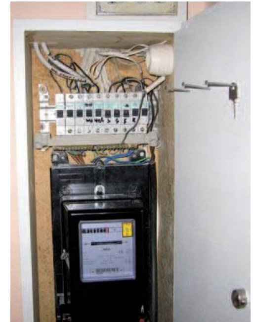
Bild von einem „extremen“ Zählerschrank im Altbau, Quelle: de - Fachzeitschrift für das Elektrohandwerk
