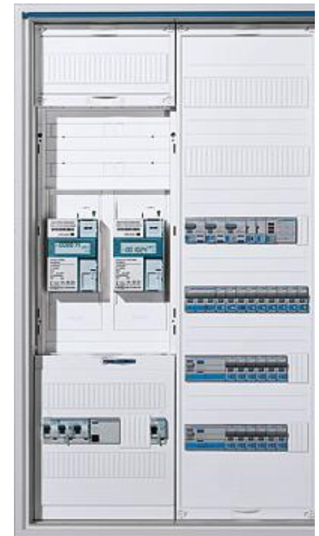
Beispiel für fertiggestellten Zählerschrank. Quelle: hager.de
