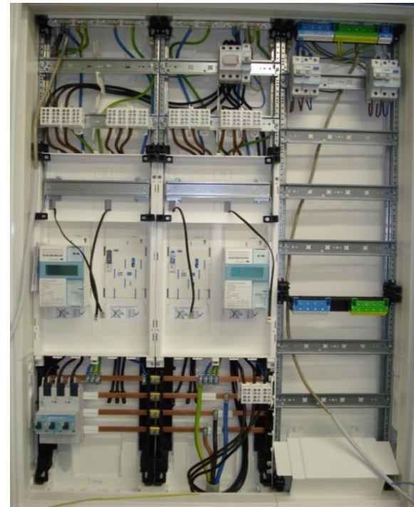
Bild des Zählerschranks für Überschusseinspeisung im Aufbau
