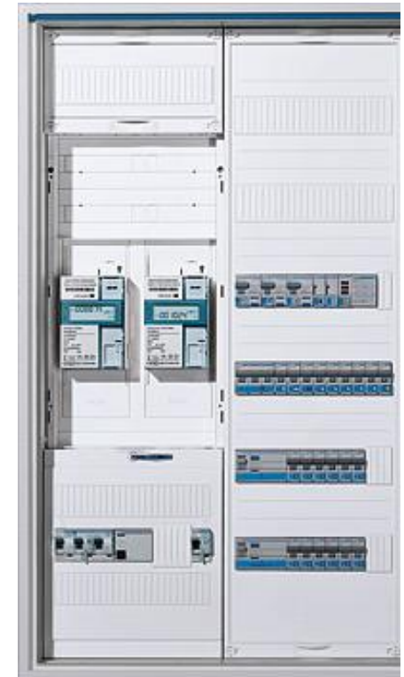
Beispiel für fertiggestellten Zählerschrank. Quelle: hager.de
