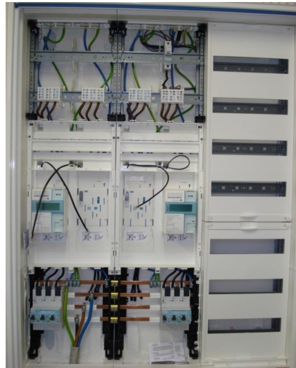
Bild des Zählerschranks für Direkteinspeisung im Aufbau
